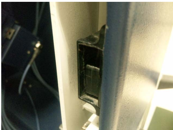
扉が閉まらない状態
