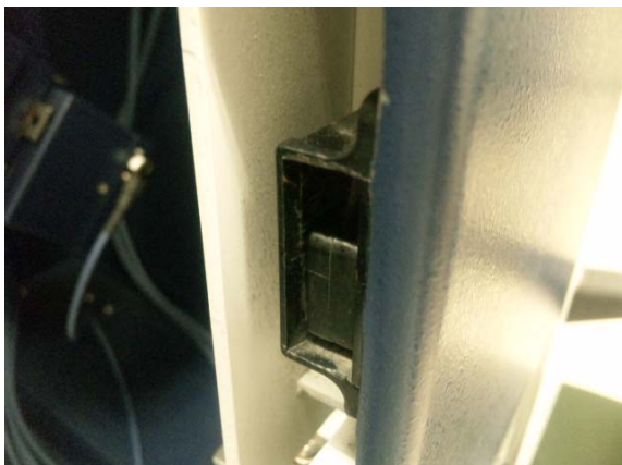
扉が閉まらない状態
